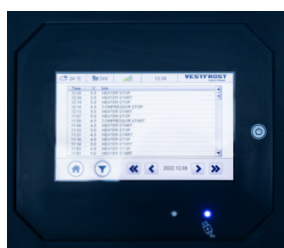
// Registro de alarmas remotas
