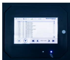
// Registro de alarmas remotas
